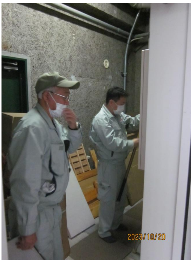
女子会館機械室 ガスメーター等があります
