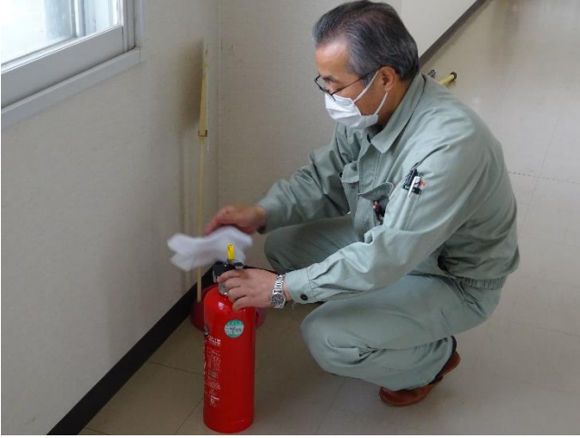
消火器の点検
